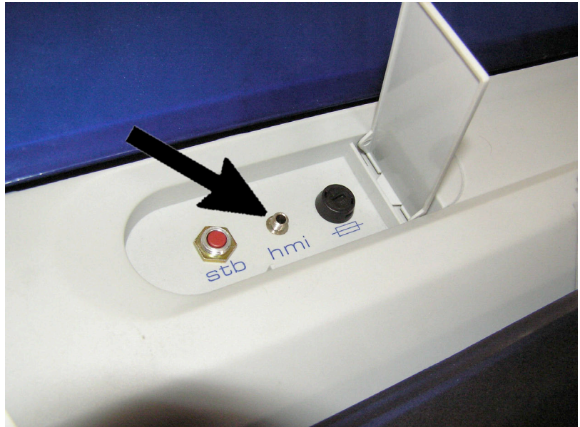
Figure 5 : Douille HMI du panneau de commutation de la chaudière
